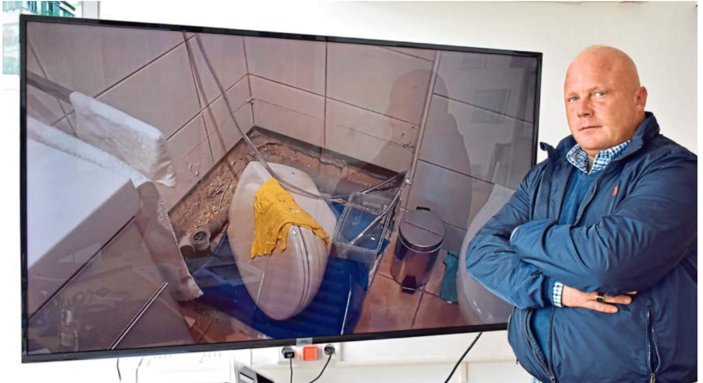
Seit Jahren kämpft der Gerichtsgutachter Maik Menke gegen die Machenschaften der „Rohr-Mafia“. Hier steht er vor dem Foto einer teuren Baustelle im Bad. Die Täter ließen sie nach der ersten Zahlung so zurück. Den Opfern drohen weitere Kosten. FOTO: MAREIKE KÖSTERMEYER
