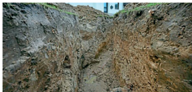
So sah es im April 2021 im Garten von Gunnar Kreutner aus, nachdem die Rohrmafia in Bielefeld-Heepen völlig unnötig einen tiefen Graben ausgehoben hatten.
