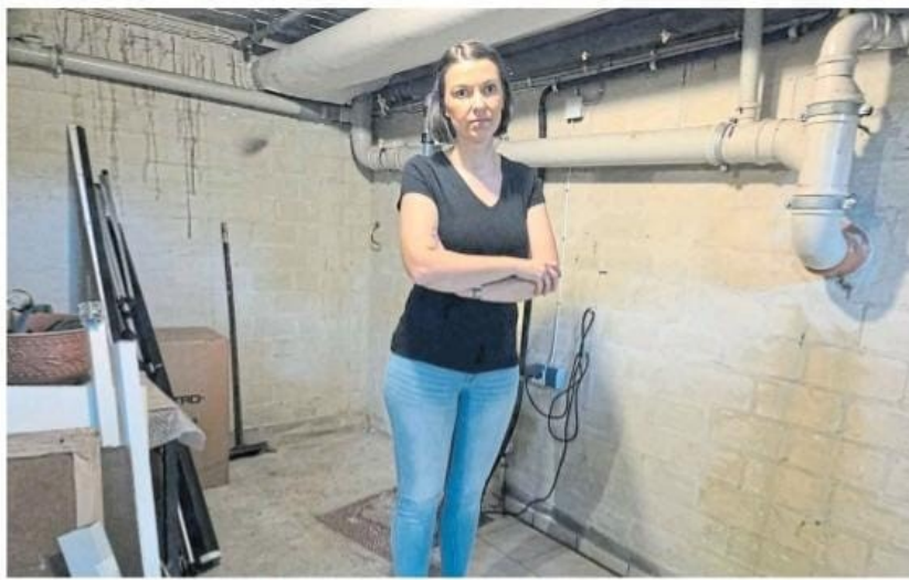
Franziska Leibert steht im Keller. Dort kam das Wasser aus den Rohren. Deshalb benötigte das Paar dringend Handwerker. MT-Foto: Ilja Regier
